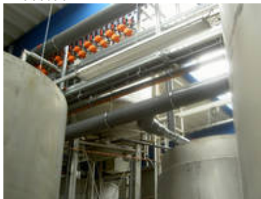
Rohrleitungen und Verteiler
